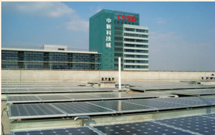
苏州中新科技城 50KWp 光伏微网系统
